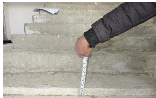
Photo 4 - Uneven Stair Risers
